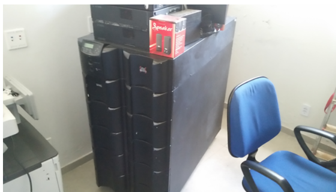
Gabinete do equipamento Nobreak localizado na sala de informática da Administração Regional. Foto em 29/11/2019.
