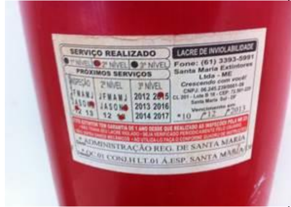
Extintor de incêndio vencido instalado na sala do almoxarifado
