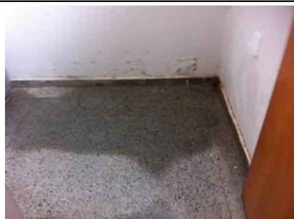
Piso do almoxarifado com infiltração apresentando risco aos itens armazenados
