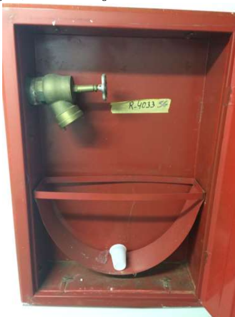
CAIXA DE HIDRANTE SEM MANGUEIRA NA PMDF
