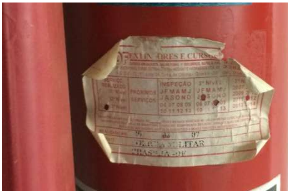
EXTINTOR VENCIDO EM 2012 NA PMDF
