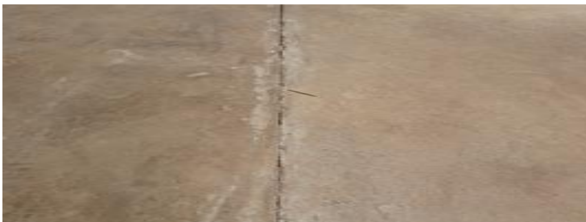
Figura 3 - PRAÇA ESTAÇÃO 16 - Necessidade de melhoria no acabamento das juntas de concretagem
