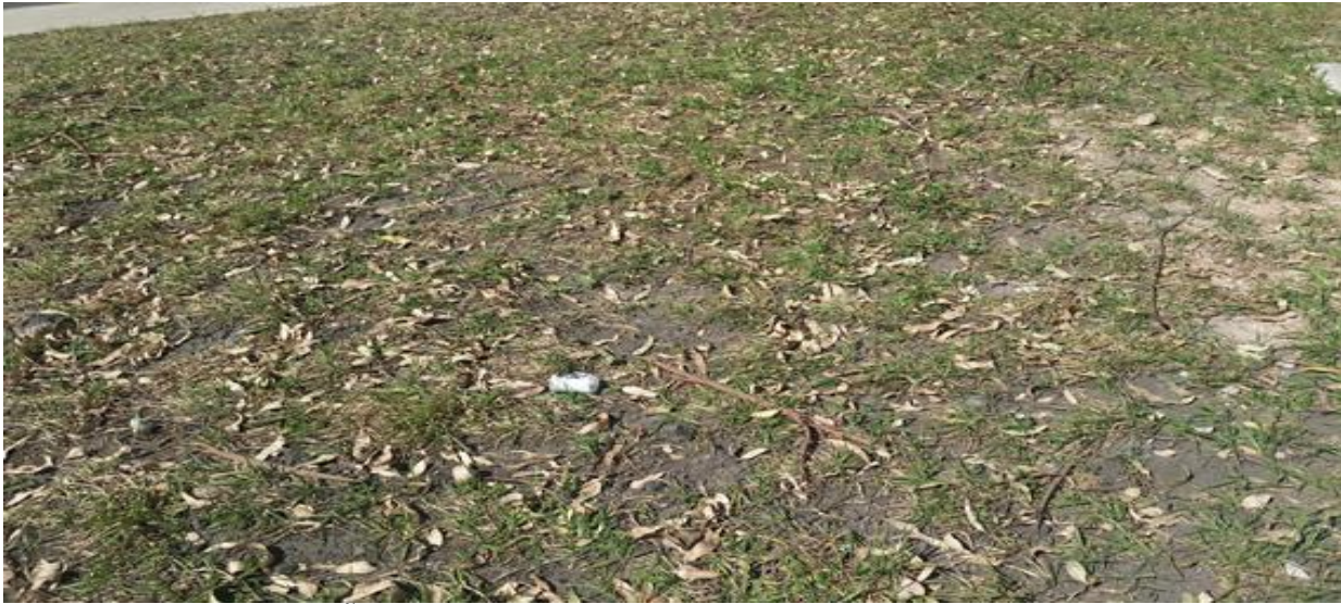
Figura 4 - PRAÇA ESTAÇÃO 16 - Execução de plantio de grama em desacordo com o contrato
