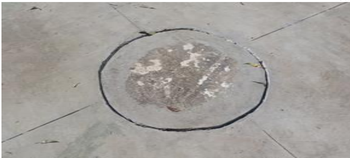
Figura 2 - PRAÇA CANÁRIO - Ausência de alças em dois poços de visita da CAESB.
