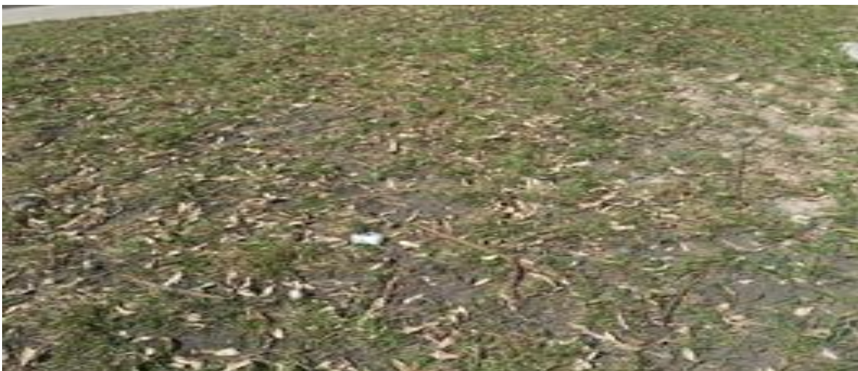
Figura 1 - PRAÇA CANÁRIO - Execução do plantio de grama em desacordo com o contrato.
