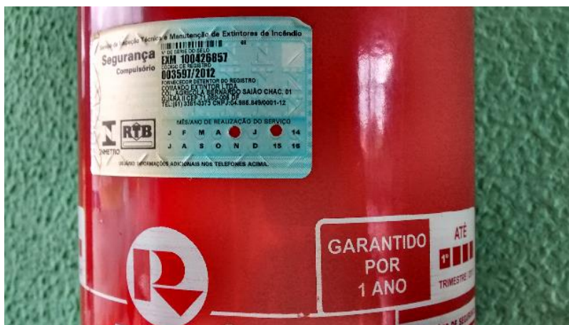
Extintor de incêndio com validade expirada em junho de 2014
