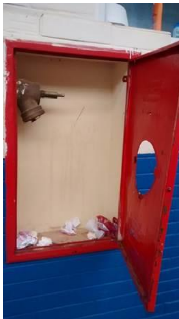
Ausência de mangueira de incêndio
