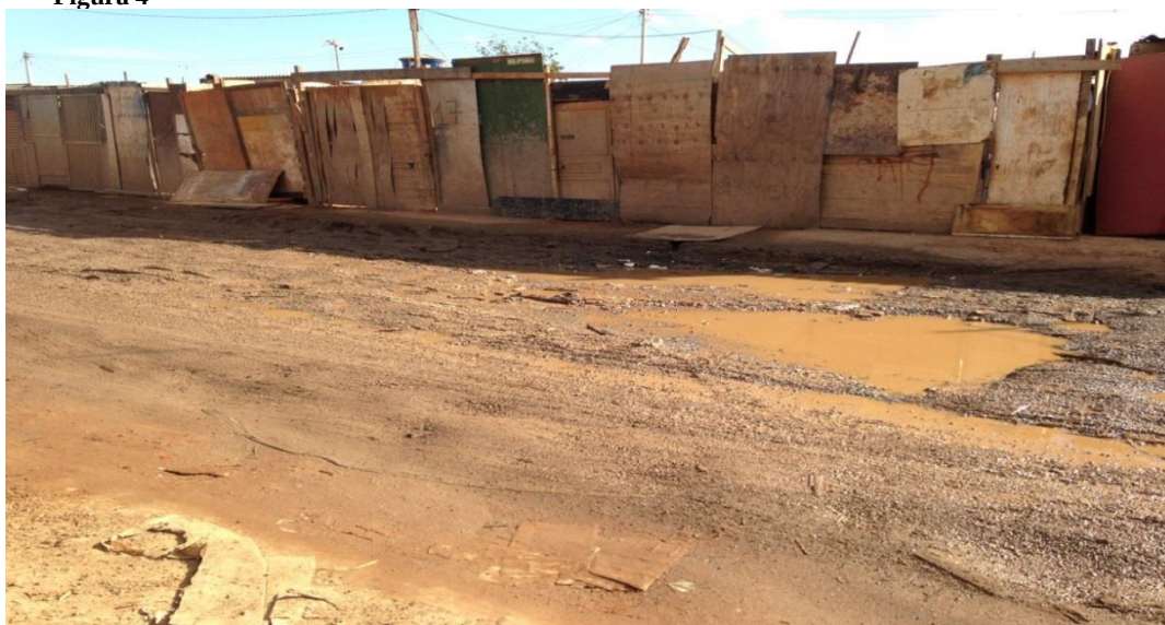
Poças de acumulação de água Data 25/06/2015
