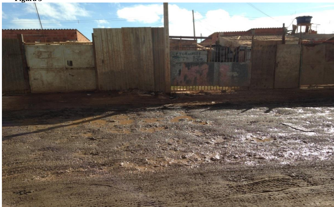
Pavimentação completamente deteriorada Data 25/06/2015
