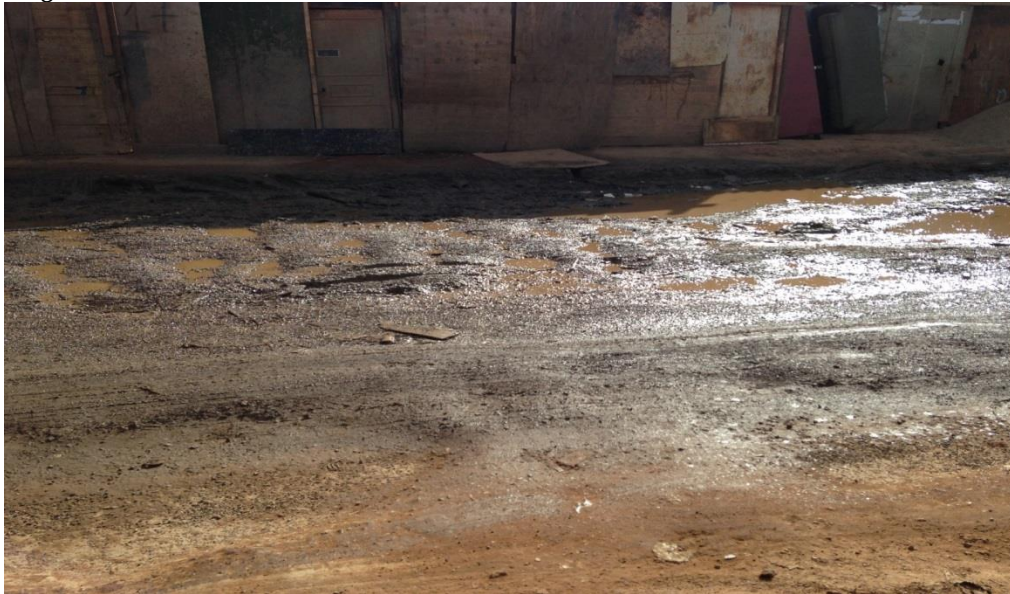
Pavimentação deteriorada Data 25/06/2015
